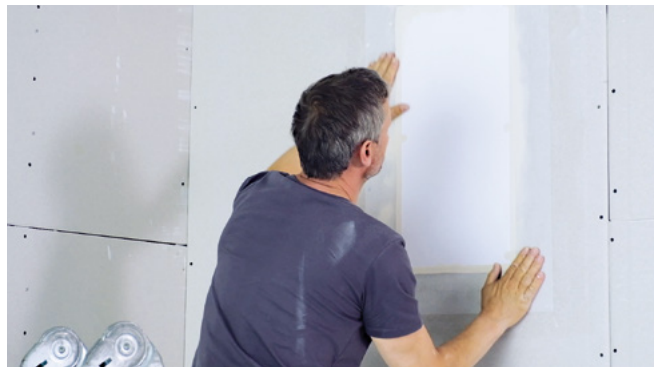
Vlies auf den noch feuchten Kleber aufziehen. Mit der Hand oder trockener Rolle andrücken. Mindestens 24 Std. trocknen lassen!
