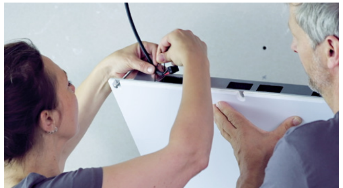
Lautsprecherkabel anschließen und zugentlasten. Dann den Lautsprecher einsetzen und mit den ersten zwei Schrauben fixieren.
